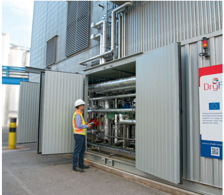
Industrielle Wärmepumpen – im Bild die DryFiciency-Anlage bei der AGRANA in Pischelsdorf – können in vielen Industriesektoren eingesetzt und in bestehende Anlagen integriert werden.
